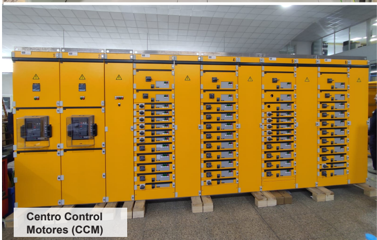
Taller de Cuadros Eléctricos propio
